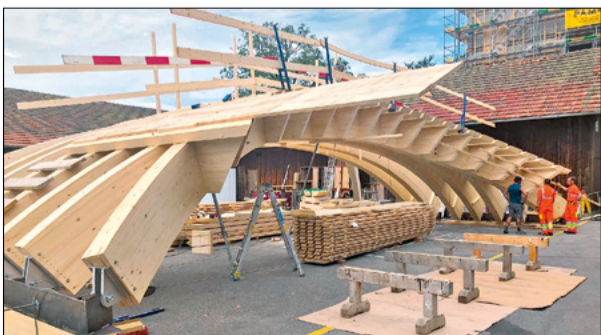
Vormontage der Portalträger unmittelbar neben der Straße. Links sichtbar die verwendeten Stahlgelenke zum Auflager der Binder auf den Seitenwänden. Grafik und Fotos: Timbatec
