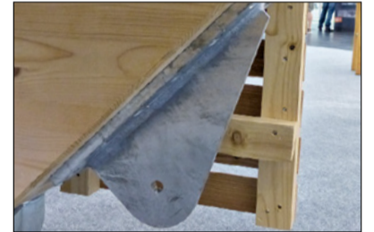
Aufgehängtes Auflager ohne Kontakt zwischen Holzträger und Widerlager
