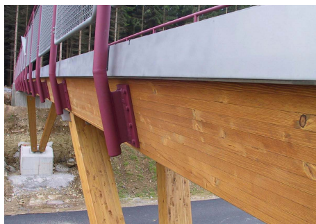
Ansicht überstehender Fahrbahnbelag
